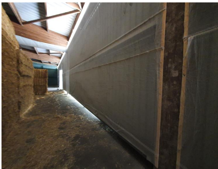
PHOTO 1 : FILETS ANTIPOUSSIERES SUR TOUTES LES FACADES INTERIEURES
